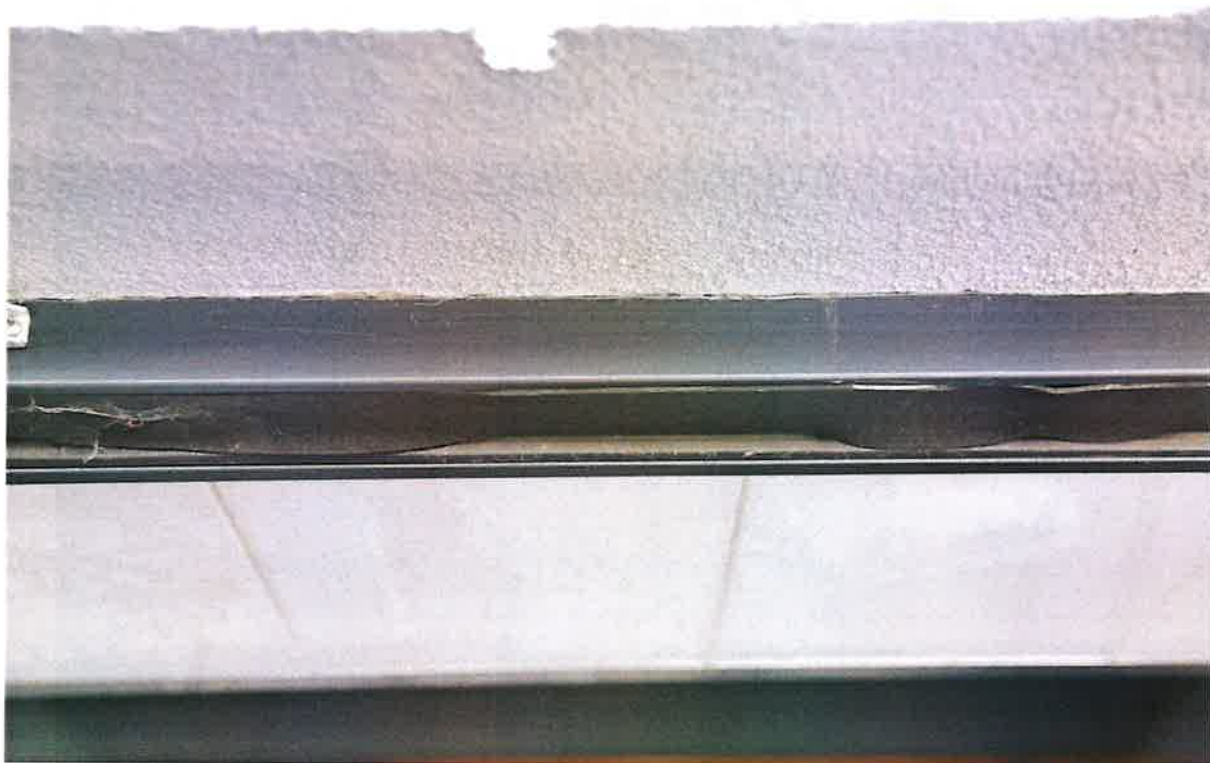
Luźna uszczelka jednych z zewnętrznych drzwi.
