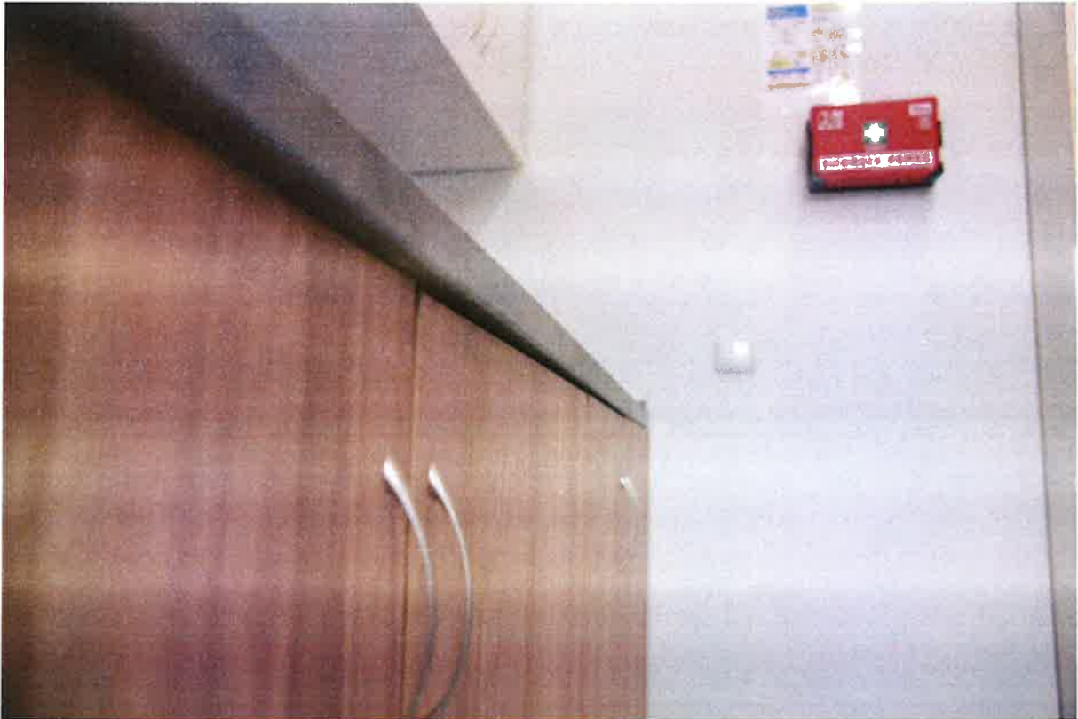
Szafki kuchenne są źle osadzone.
