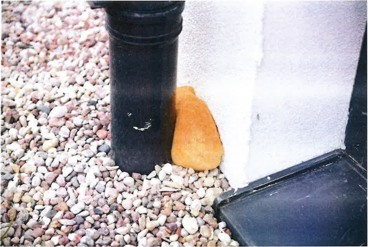
Pozostawiony bąbel pianki montażowej.
