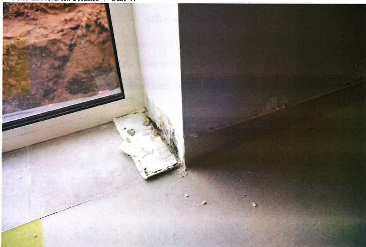
Opadają cokoliki, farba, tynk i wykładzina. Widoczna wilgoć i grzyb na ścianach.
