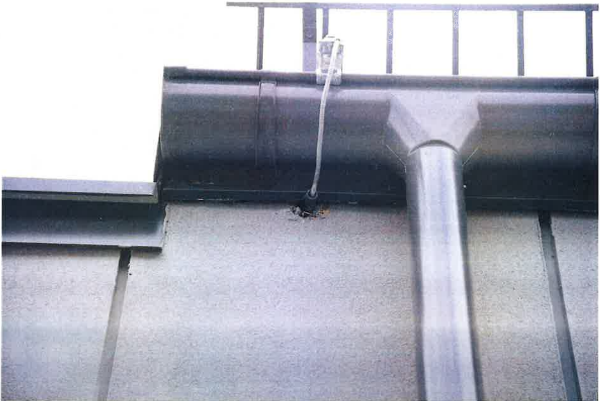
Spora dziura w elewacji po kablu od piorunochronu.
