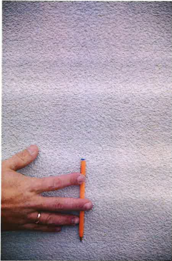
Frontowa elewacja, pod napisem posiada pionowe pęknięcie (wzdłuż długopisu).
