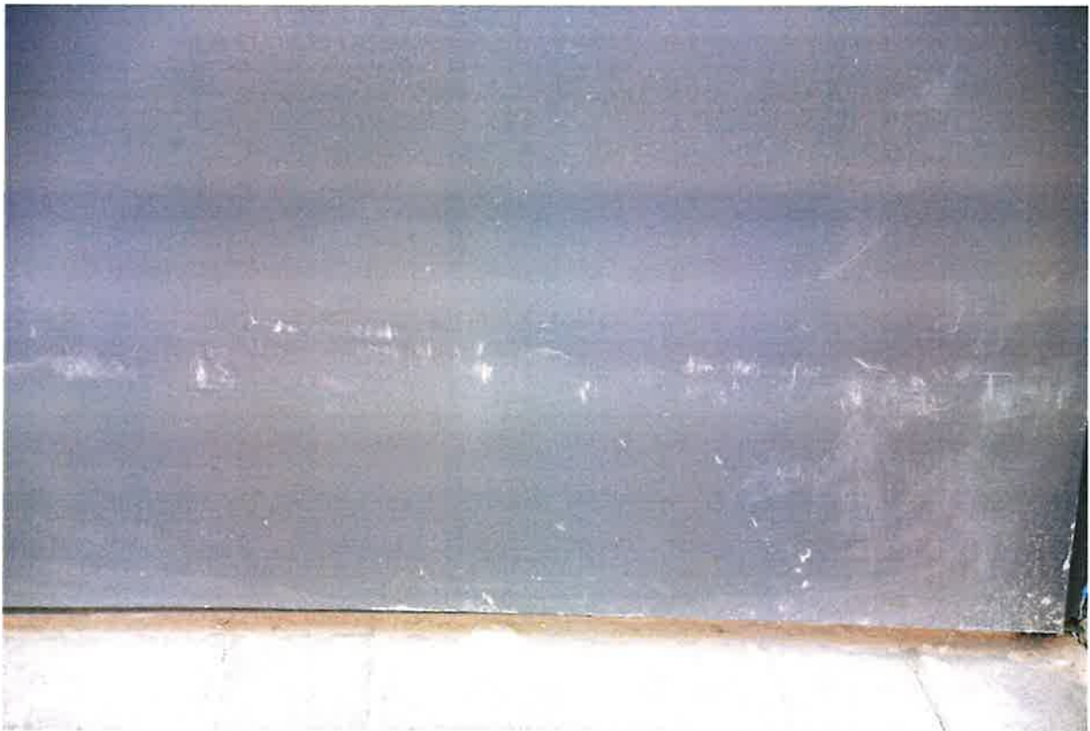
Nowe drzwi do kotłowni. Widać liczne zarysowania i wgniecenia.
