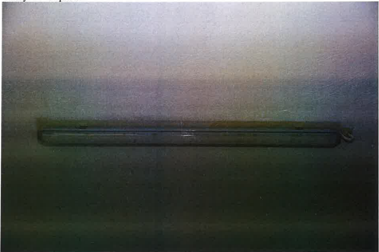
Nie pomalowano wokół oprawy oświetleniowej.
