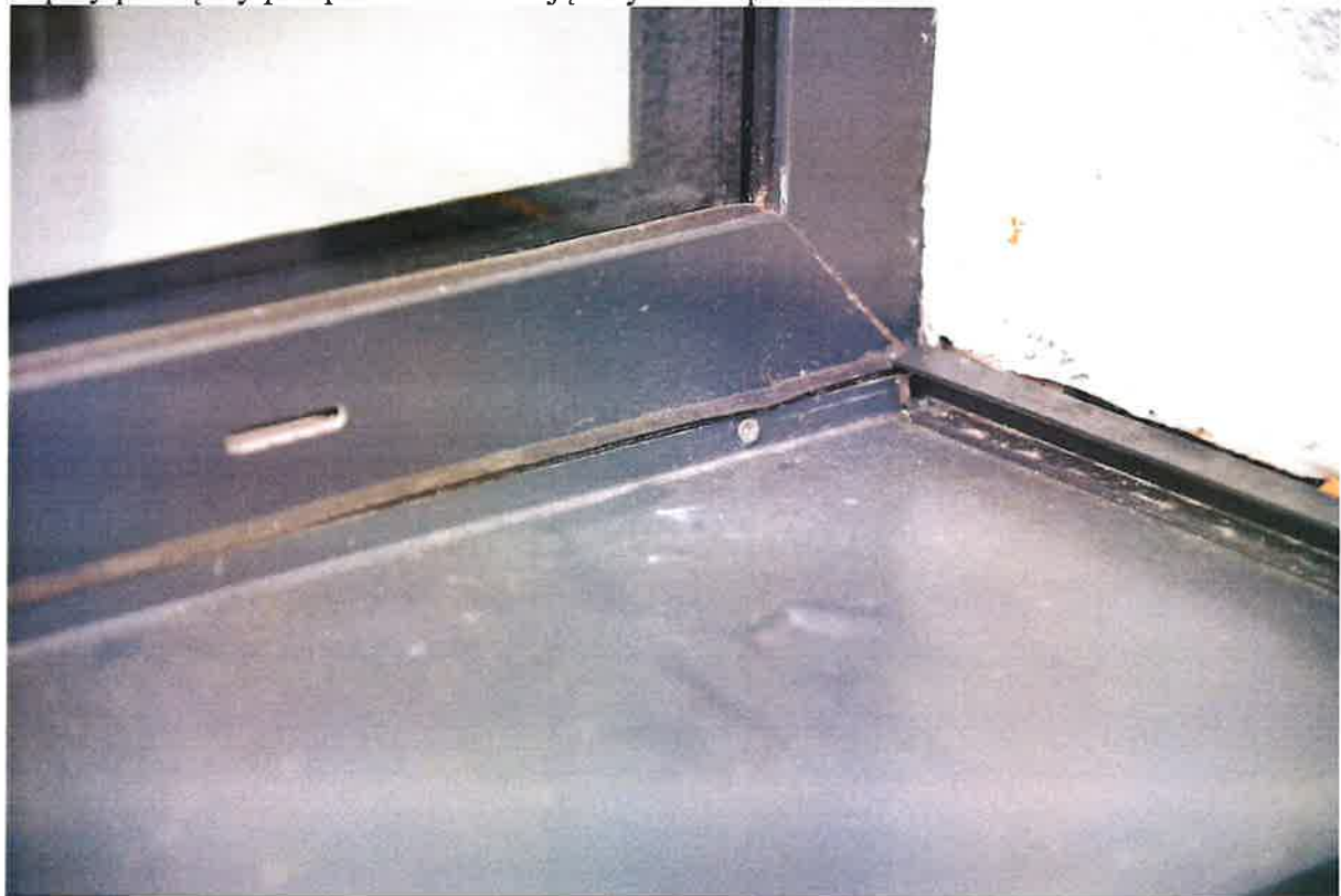
Prawie wszystkie parapety przymocowane są na wkręty do okien. Pomiędzy wychodząca i luźna uszczelka.
