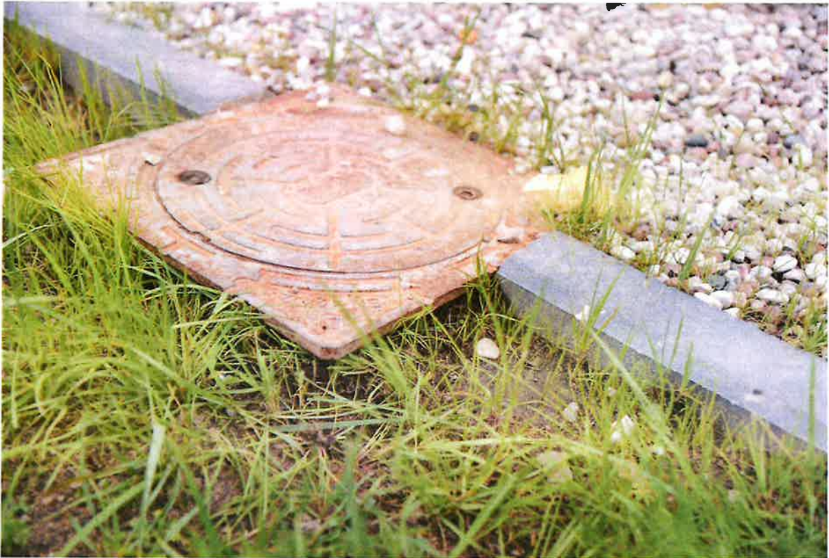
Studzienki kanalizacyjne wiszą w powietrzu.
