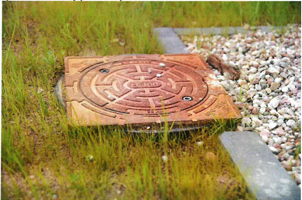
Kolejna studzienka, która wisi w powietrzu.
