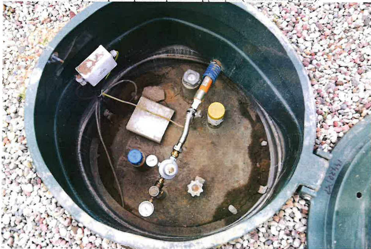
W komorze z licznikiem poziomu gazu w zbiorniku zbiera się woda. Widać, że wąż jest powyginany.
