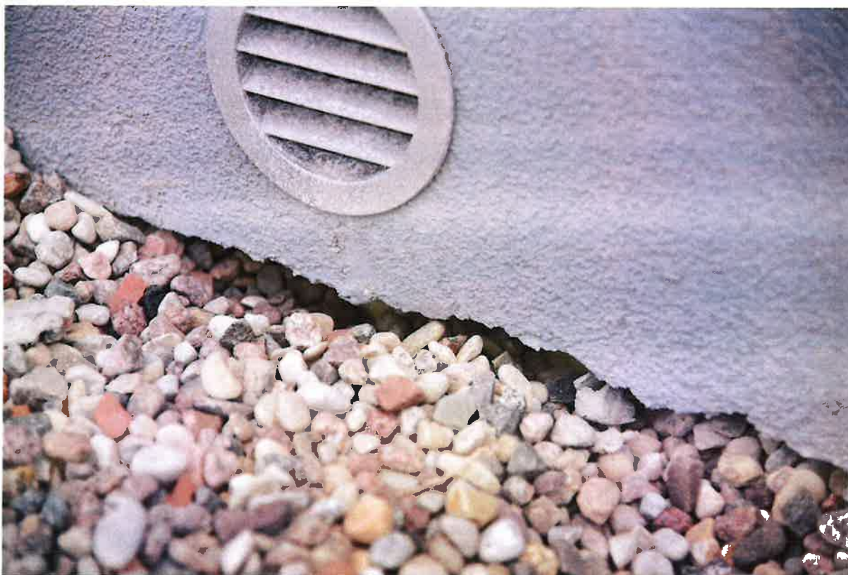
„Wykończenie” elewacji budynku, pod spodem widoczny jest styropian od fundamentów niezabezpieczony folią.
