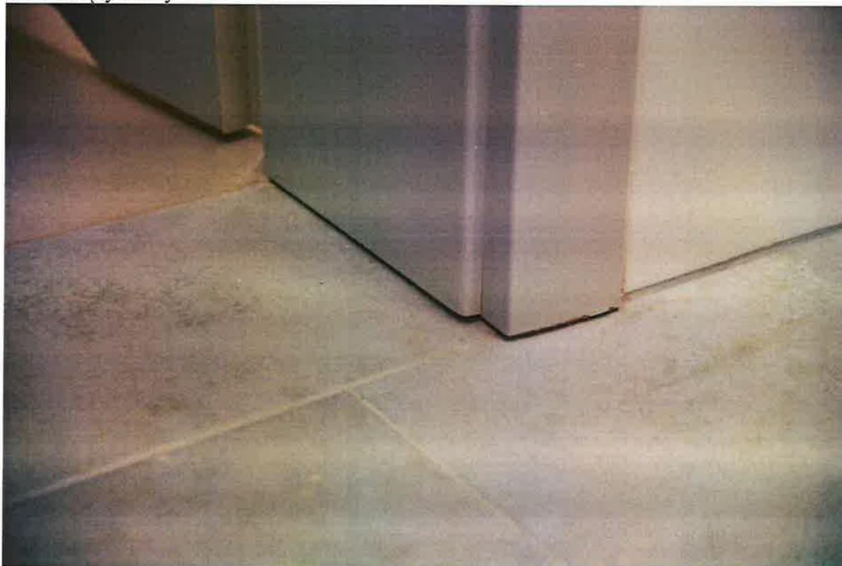
Niezabezpieczone silikonem ościeżnice drzwi.
