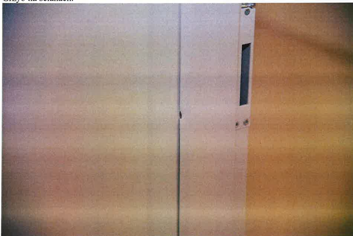
Uszkodzona ościeżnica drzwi.
