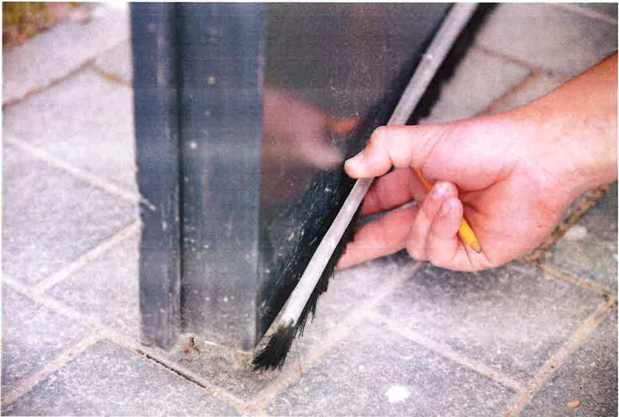
Drzwi od niektórych pomieszczeń (np. kotłownia) wyposażono w „miotelki”, które odchodzą od drzwi.
