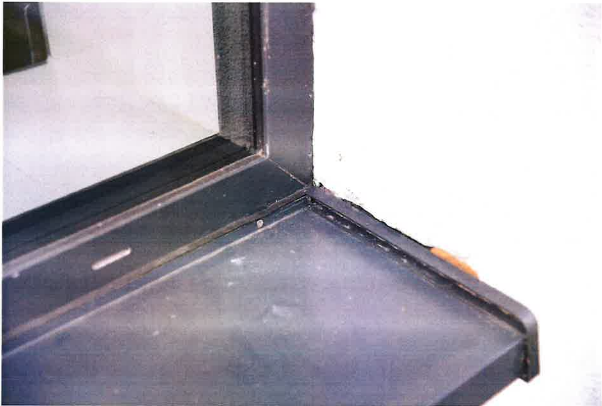
Szpary pomiędzy parapetami a elewacją. Wychodzi pianka montażowa.
