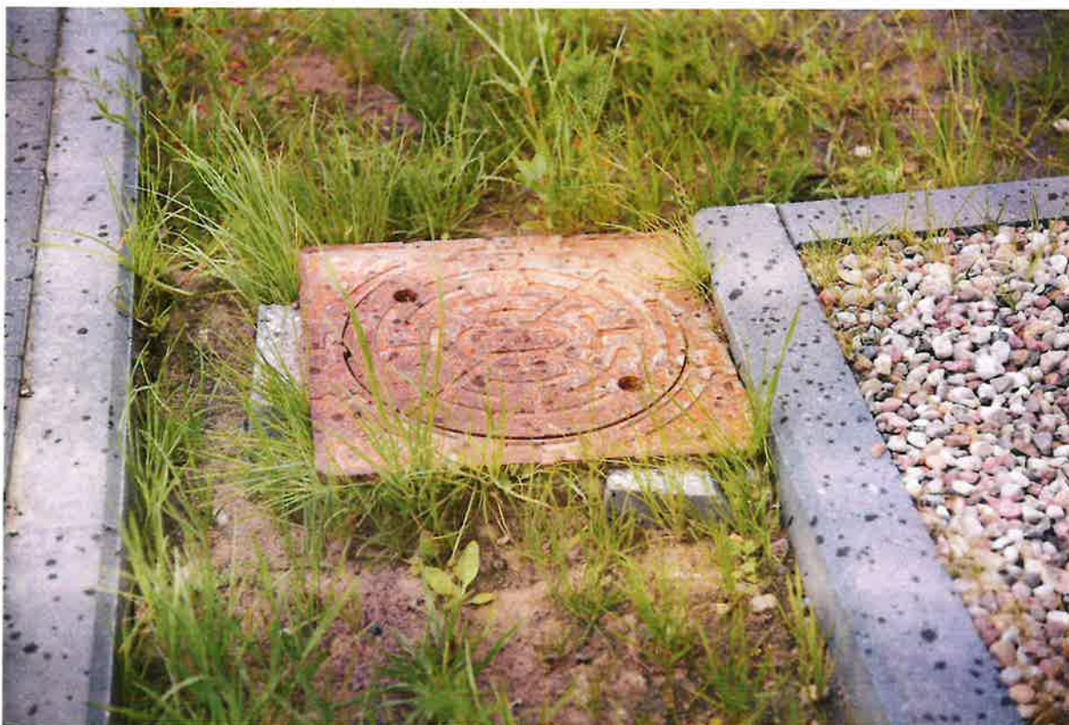
Właz studzienki kanalizacyjnej opiera się na kawałkach kostki brukowej.
