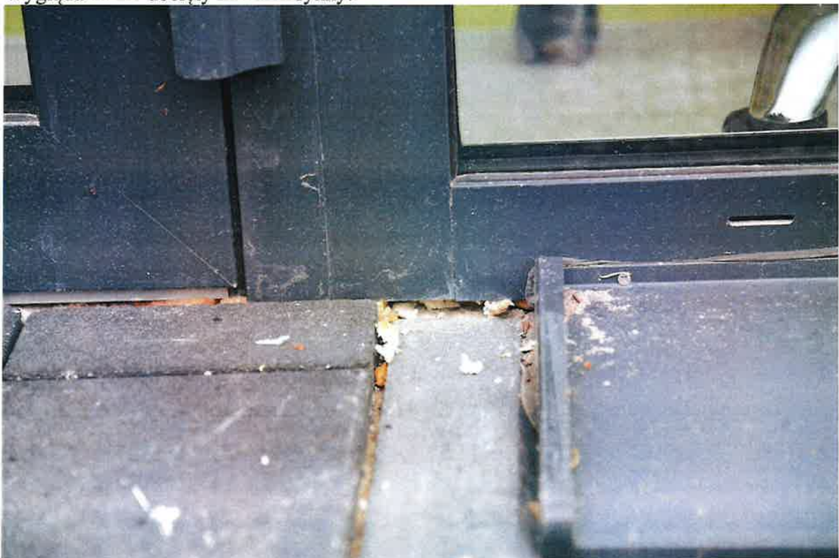
Kolejne wykończenie okna, woda może dostawać się pod spód.
