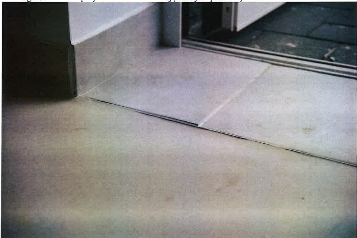
Wykończenie przy wejściu od strony ulicy Kościelnej. Płytki są nierówne, nie licują się z podłogą. Dodatkowo są luźne i puste w środku.
