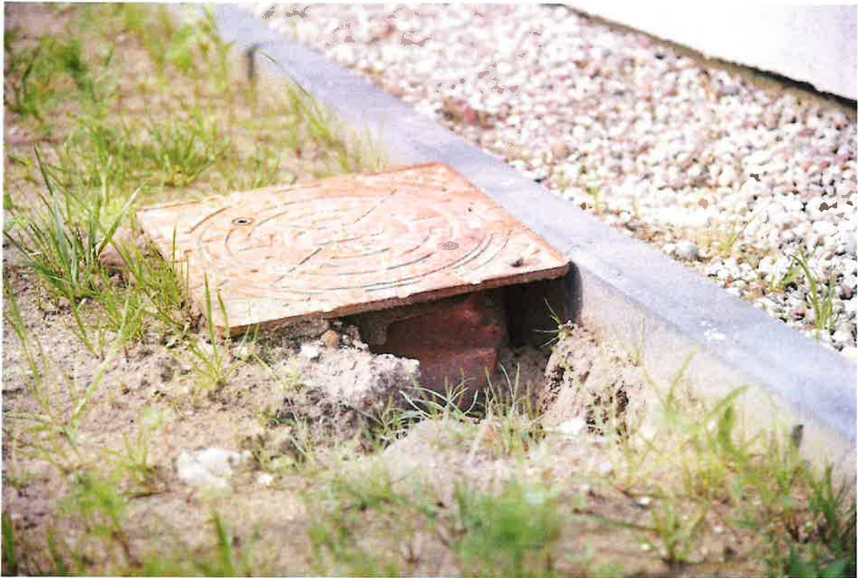
Podmyta, unosząca się w powietrzu studzienka kanalizacyjna.
