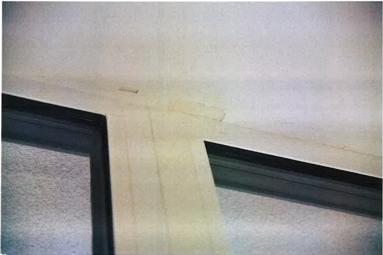
Odchodzi farba i tynk przy oknach.
