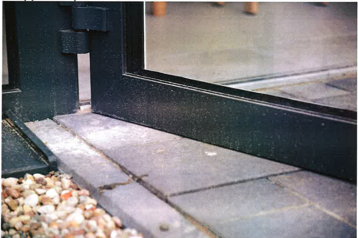
Drzwi do jednej z sal szorują po kostce brukowej. Brak odbojników.
