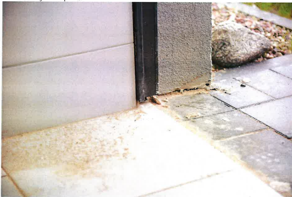
Brak prog w drzwiach.
