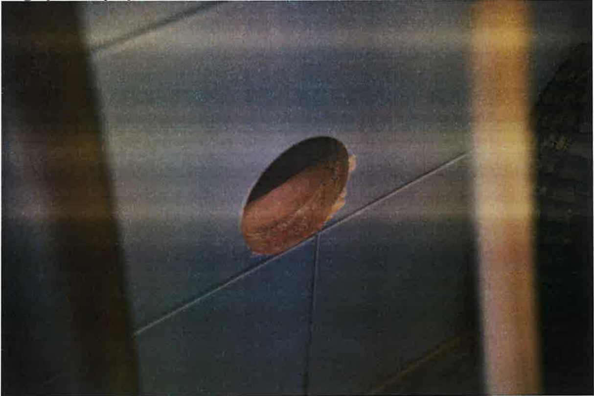
Brak kratki wentylacyjnej od środka pomieszczenia.
