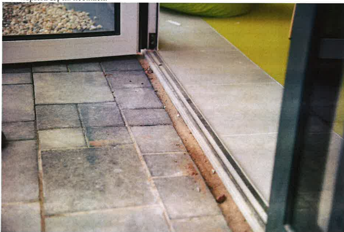
Brak wykończenia drzwi zewnętrznych drzwi wejściowych do jednej z sal zajęciowych.
