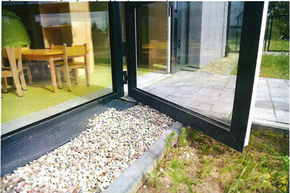
Drzwi zewnętrzne do sal nie posiadają ograniczników, co najprawdopodobniej poskutkowało uszkodzeniem listwy parapetu. Listwa jest pęknięta.
