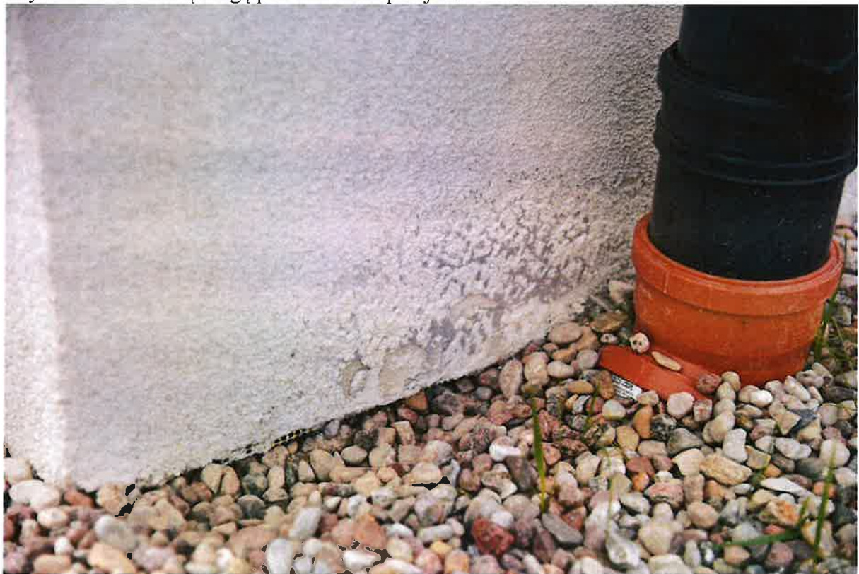
Wymyta lub niedorobiona elewacja przy odpływie rynny.
