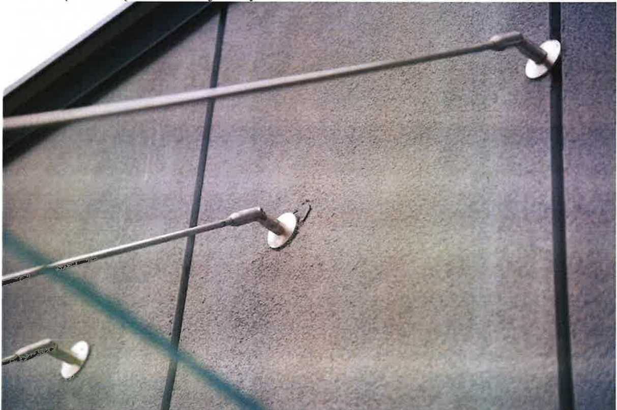
Mocowanie drugiego szklanego daszku wygląda jakby miało się wyrwać z elewacji. Widać pęknięcie.
