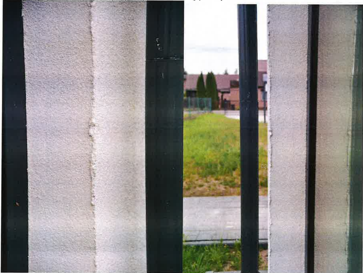
Niechlujnie obrobiony narożnik elewacji.
