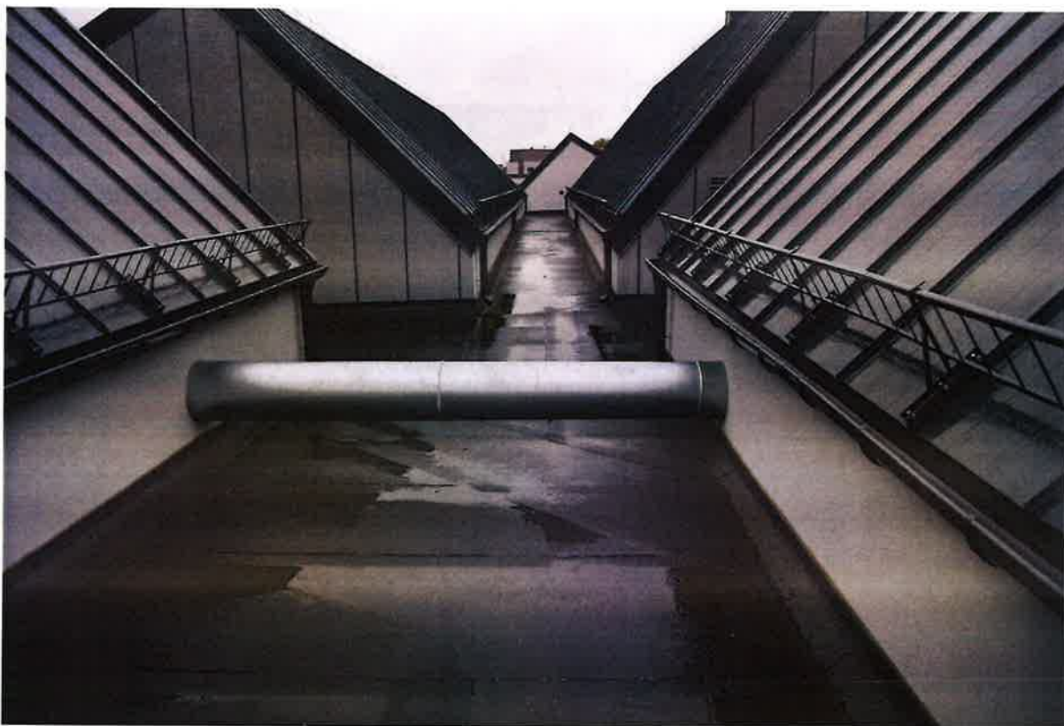
Woda stoi na dachu.
