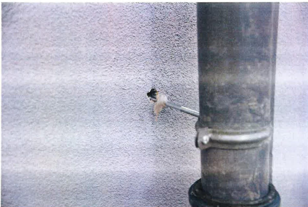
Ubytki w elewacji po kołkach montażowych zostały wypełnione bezbarwnym silikonem.
