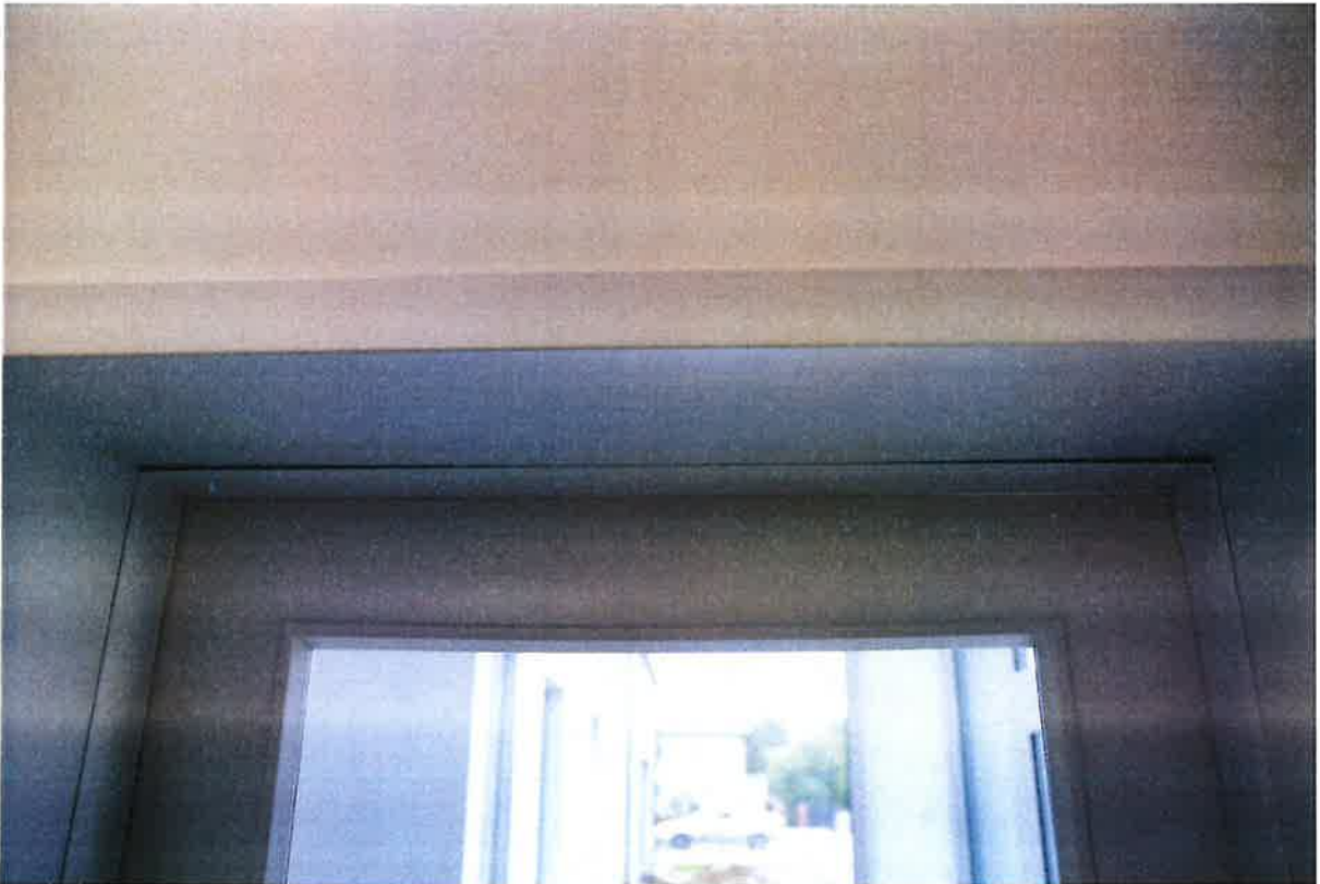
Szpary w framugach drzwi – wejście do wózkarni.
