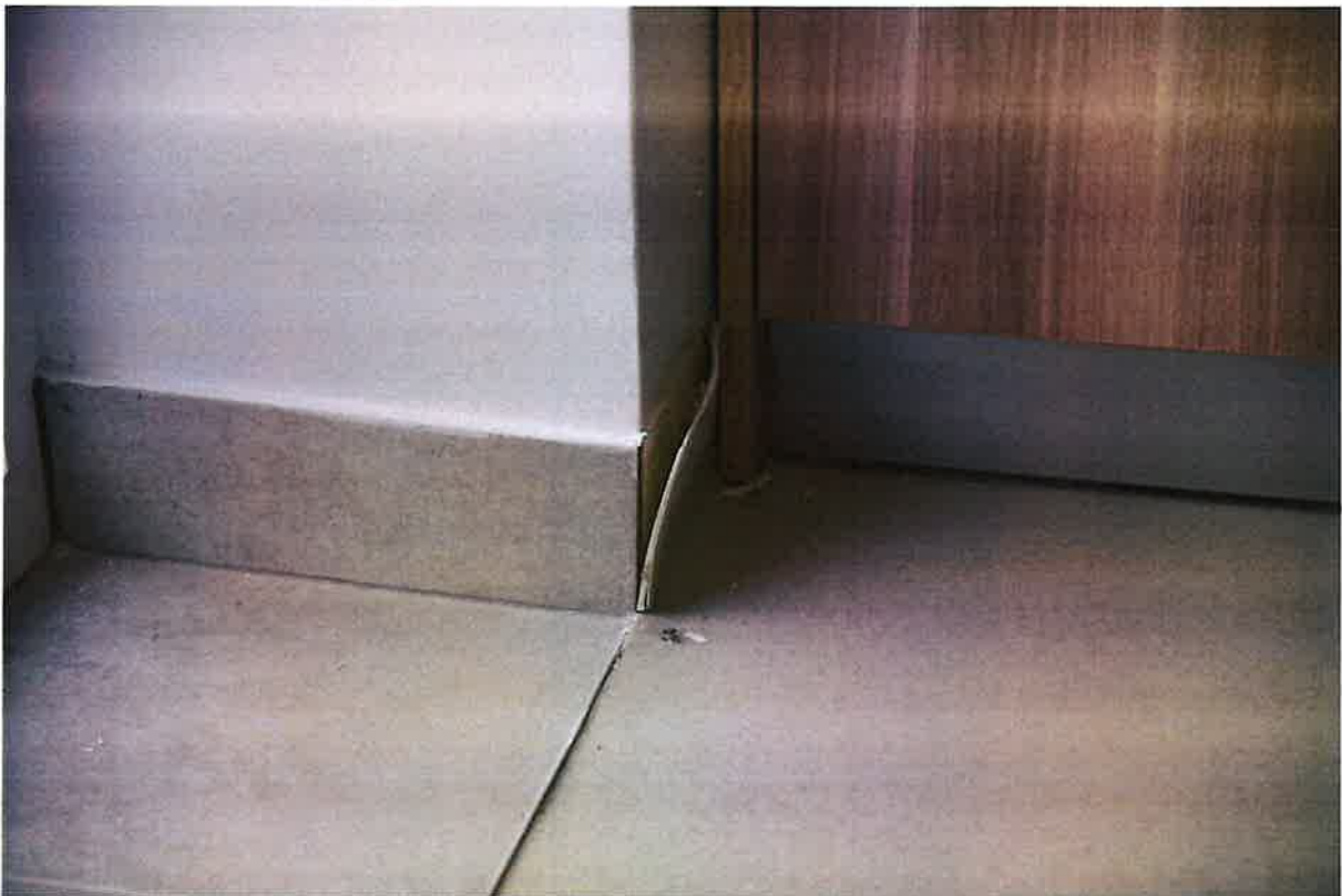
Wykładzina się odkleja, odpada tynk przy oknach.
