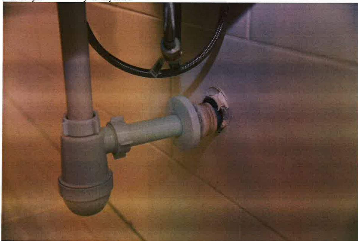
Wypadający syfon odpływowy.
