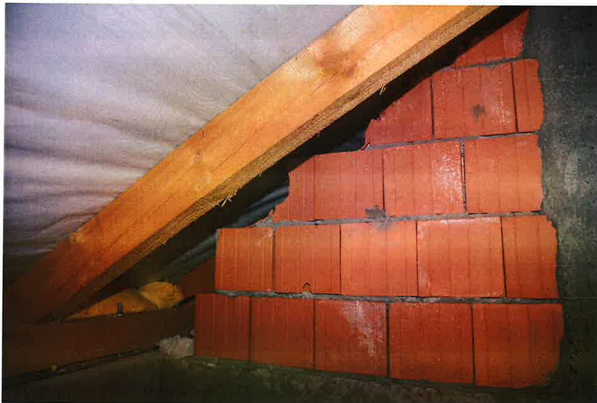
Brak dociętych pustaków przy ścianach szczytowych. Wszystkie pomieszczenia.
