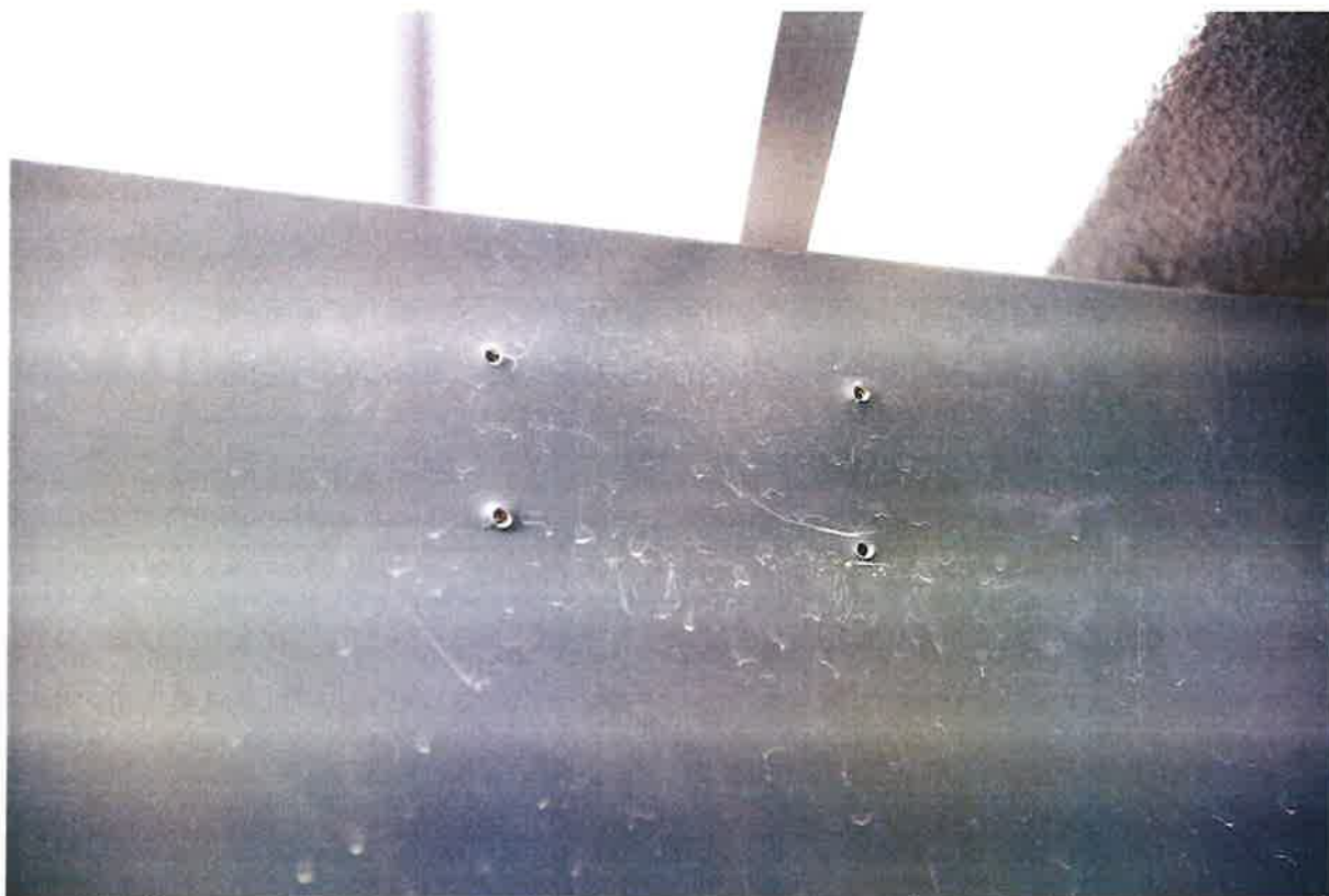
Dziury po prawdopodobnie błędnie zamontowanym mechanizmie samozamykacza.
