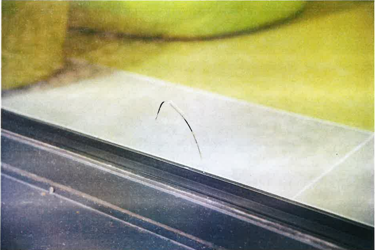
Szyba w oknach w jednej z sal jest pęknięta od wewnątrz.
