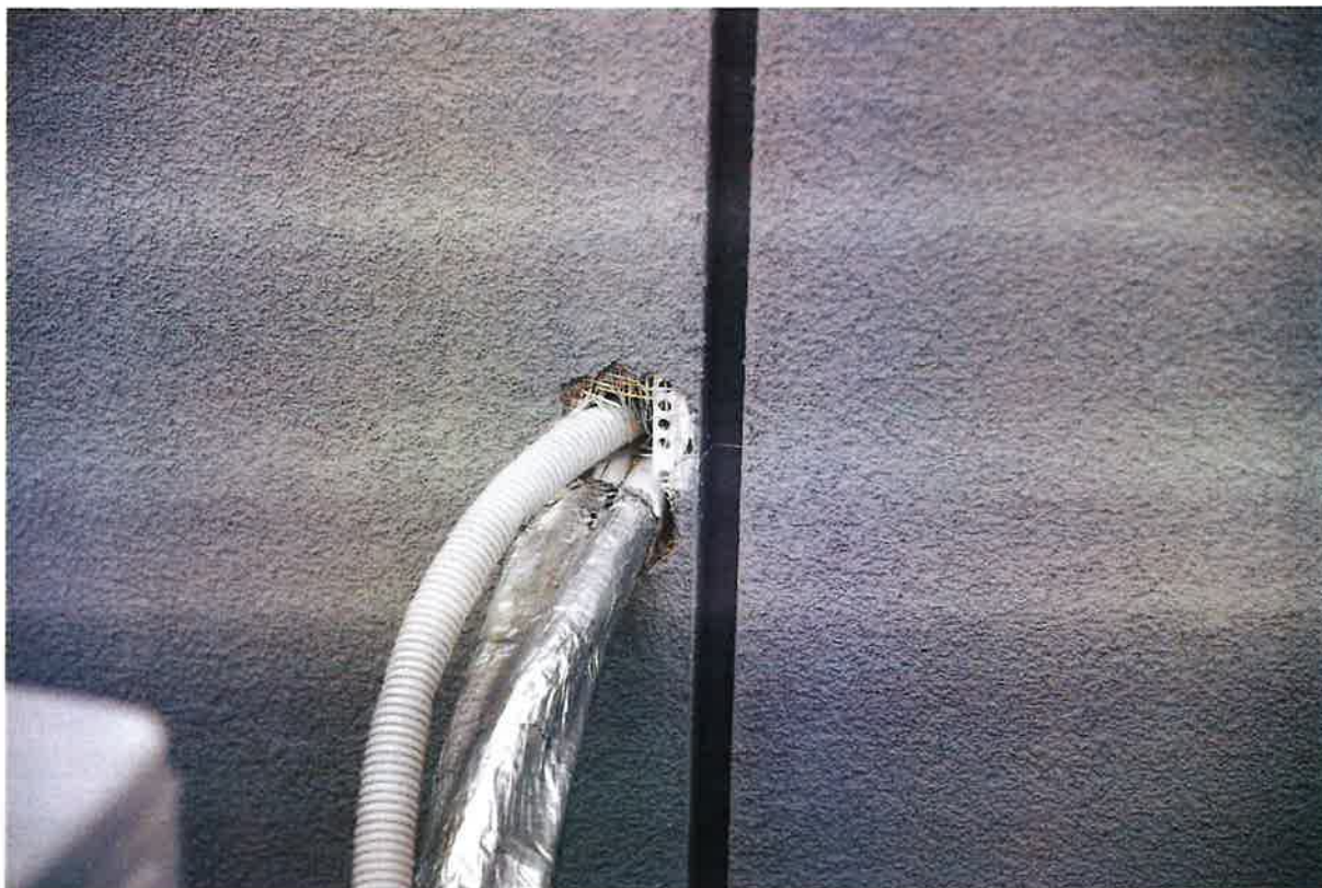
Uszkodzona elewacja przy wentylatorach od klimatyzacji.
