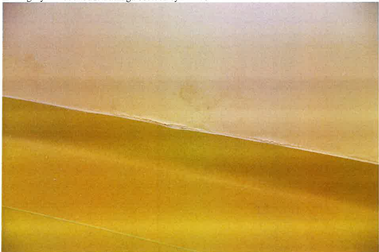
Dodatkowo, to co w poprzednich przypadkach, wilgoć, zacieki i odchodząca wykładzina.
