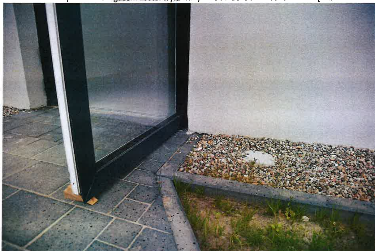
Brak ogranicznika w drzwiach głównych (front budynku).
