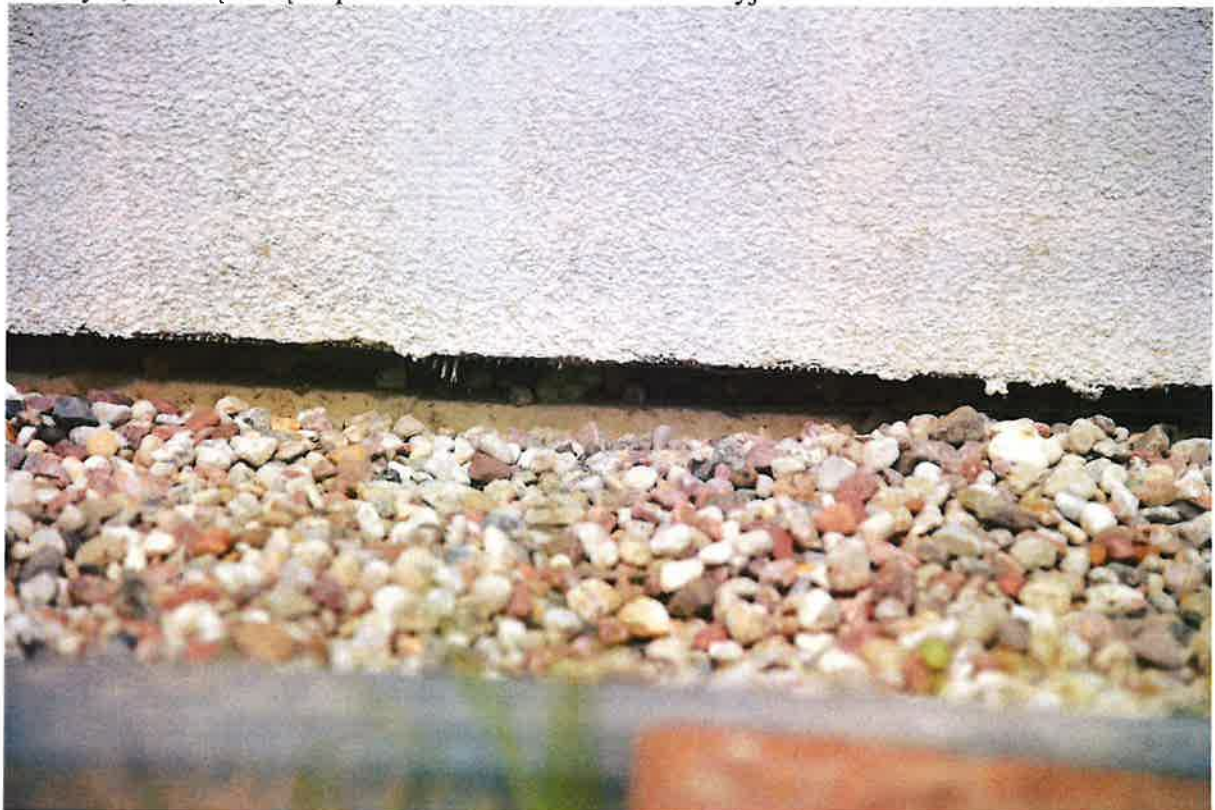
Pomiędzy elewacją budynku a fundamentami jest spora szpara widoczna na zdjęciu.
