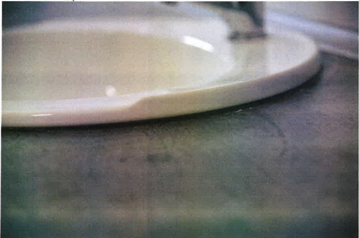
Umywarka wygląda jakby była osadzona na warstwie silikonowej.
