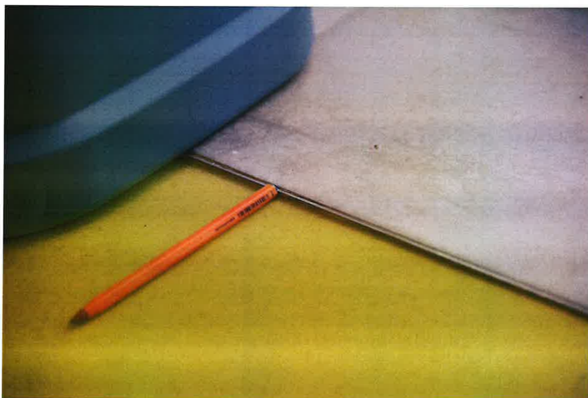
Podłoga nie licuje się z płytkami przy oknach.
