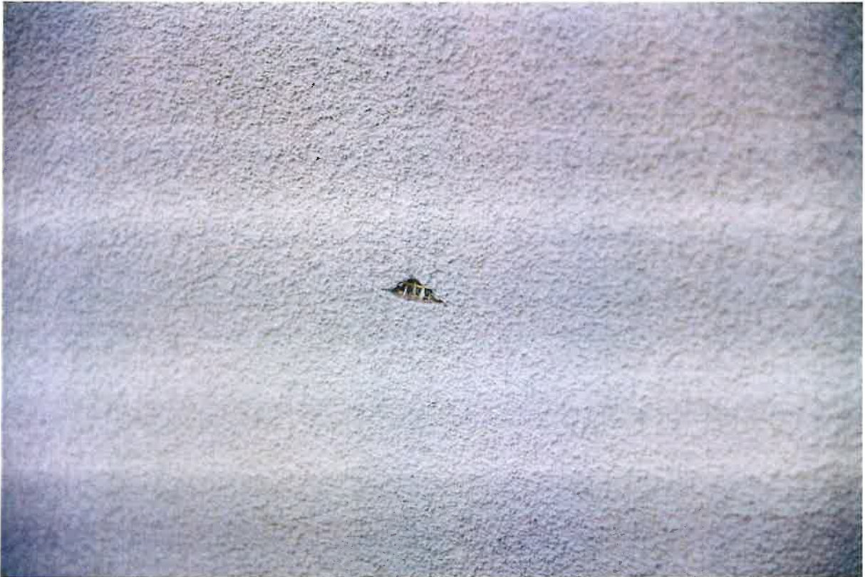
Drobne ubytku w elewacji.
