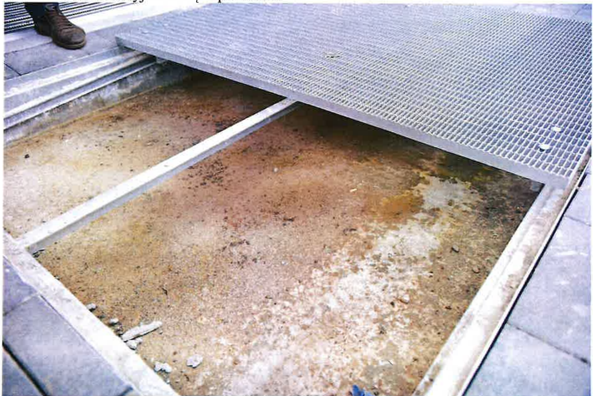
Brak odwodnienia przy wejściu głównym. Woda stoi na spodzie, który jest najprawdopodobniej wybetonowany.
