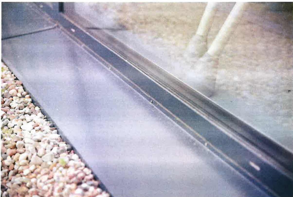
Kolejne parapety (jedna z sal zajęciowych), które przykręcone są do okien. Brak zaślepek odpowietrzników.
